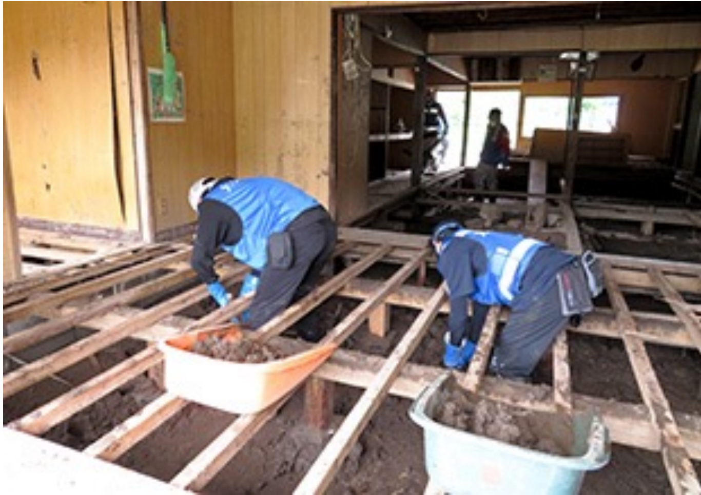
出所：大分大学HP 民家の床下の泥出し作業を行う学生（2020.7.22 九重町）
